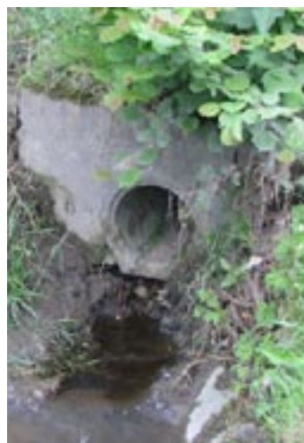
Rejet d'eaux usées domestiques
