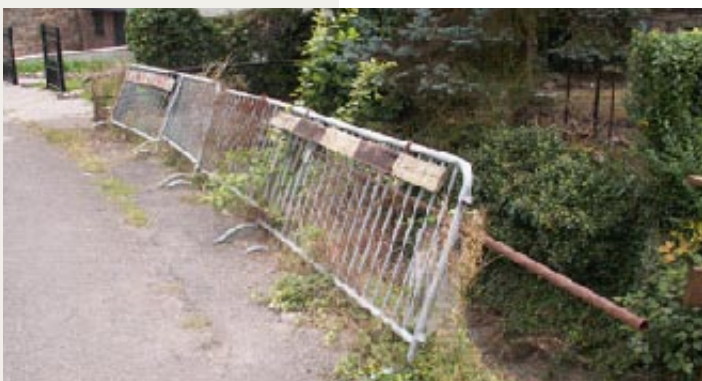
Parapet fortement dégradé
