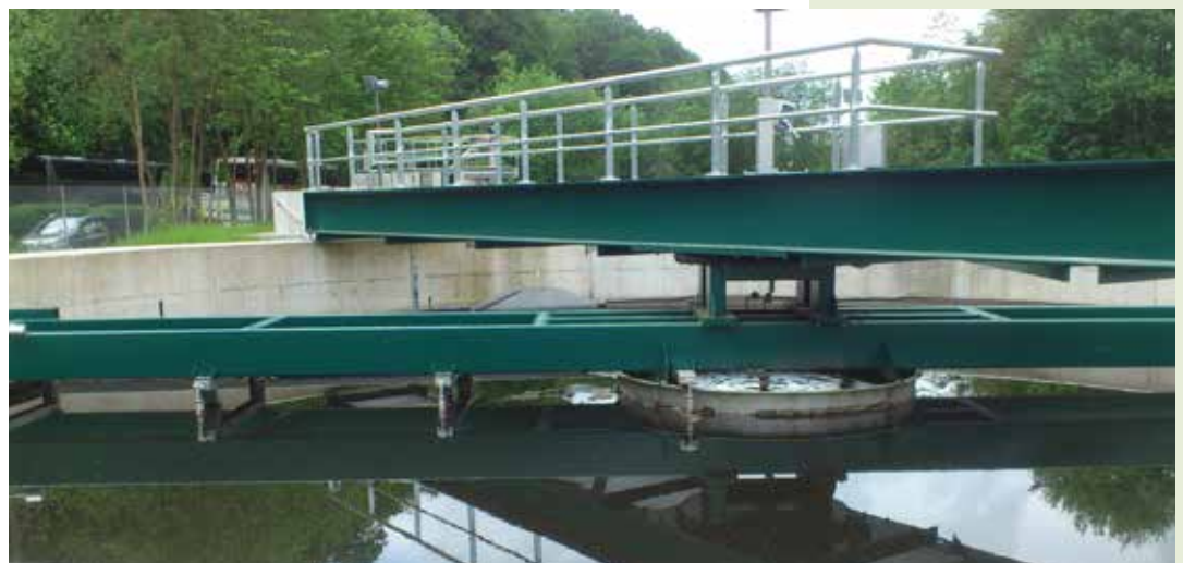
Clarificateur ou décanteur secondaire
